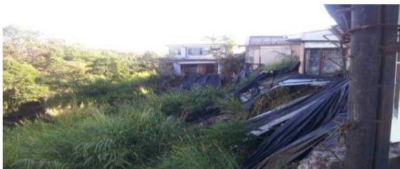
Ilustración 5: Condición de la parte trasera de las viviendas
