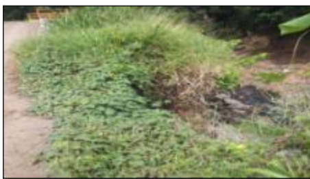
Fotografías 2 y 3: Afectación de la margen izquierda de la Quebrada Seca
